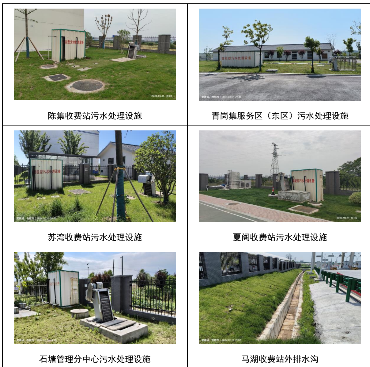
图 8.3-4 污水处理设施照片
