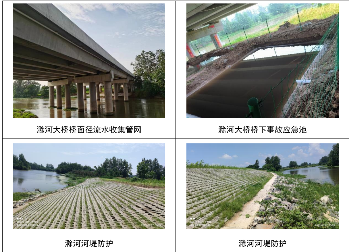
图 8.3-1 滁河大桥水污染防治设施照片
